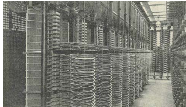
Den första helautomatiska telefonstationen i Stockholm installerades av L M Eriksson 1924
